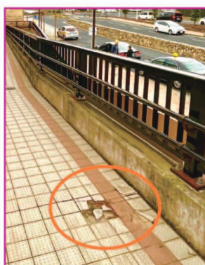
㉓ タイルの補修前
